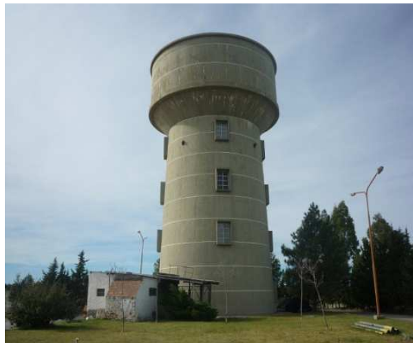
Figura 9: Tanque de almacenamiento de Monte Hermoso
