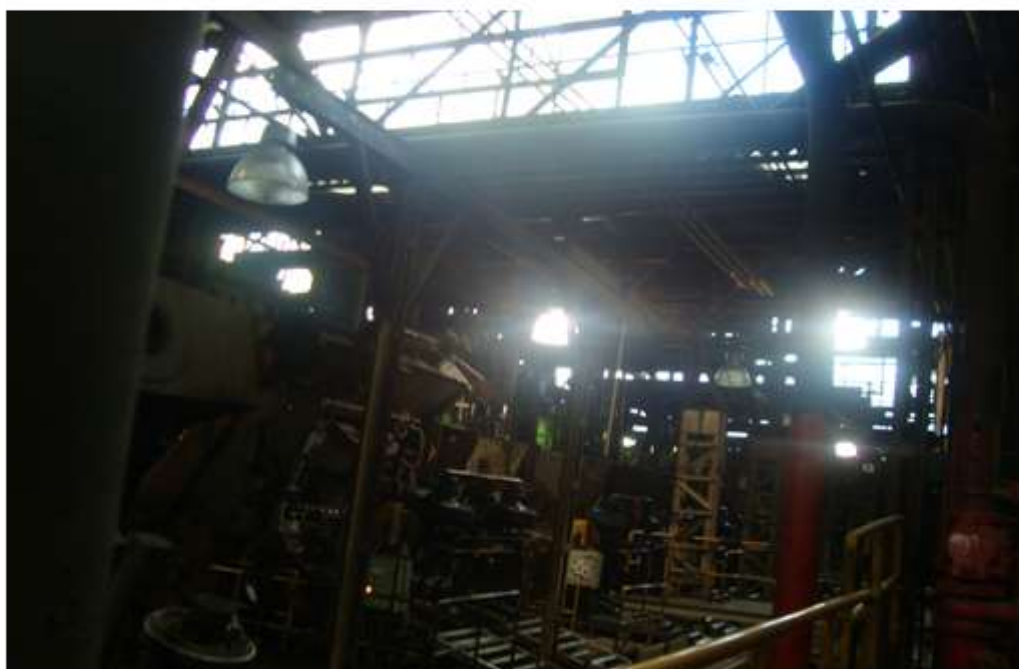
Antiguo sistema de extracción de aire de vulcanizado
