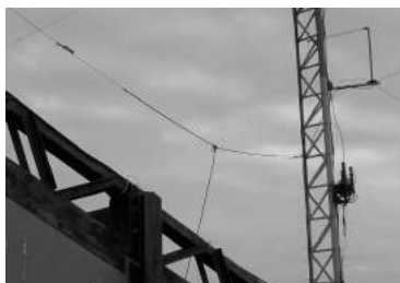
Una de las antenas instaladas por UV.
