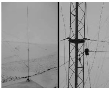
Antenas instaladas por UV para las activaciones.
