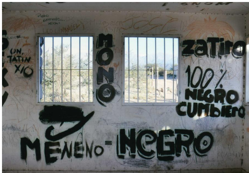
Interior de la casilla de información turística y seguridad totalmente destruida. Fuente propia, 2014
