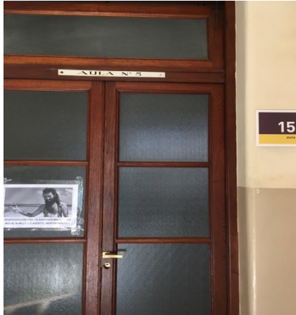
Ilustración 12- Puerta aula 15 - Fuente propia
