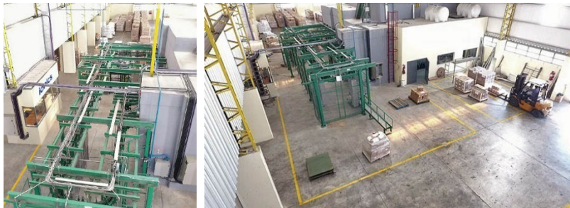
Fig. 13: Vistas panorámicas de la sala de comando, el sistema de transporte y el bunker de irradiación de la Unidad Radiante 2 de Ionics.
