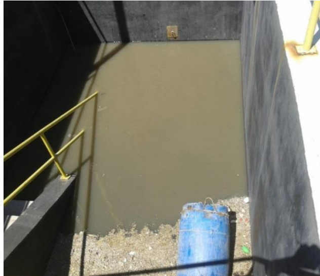
Figura 11: Estado del sistema de rejillas de LAER Villa María. Fuente: Chicala Lopez. (2014)
