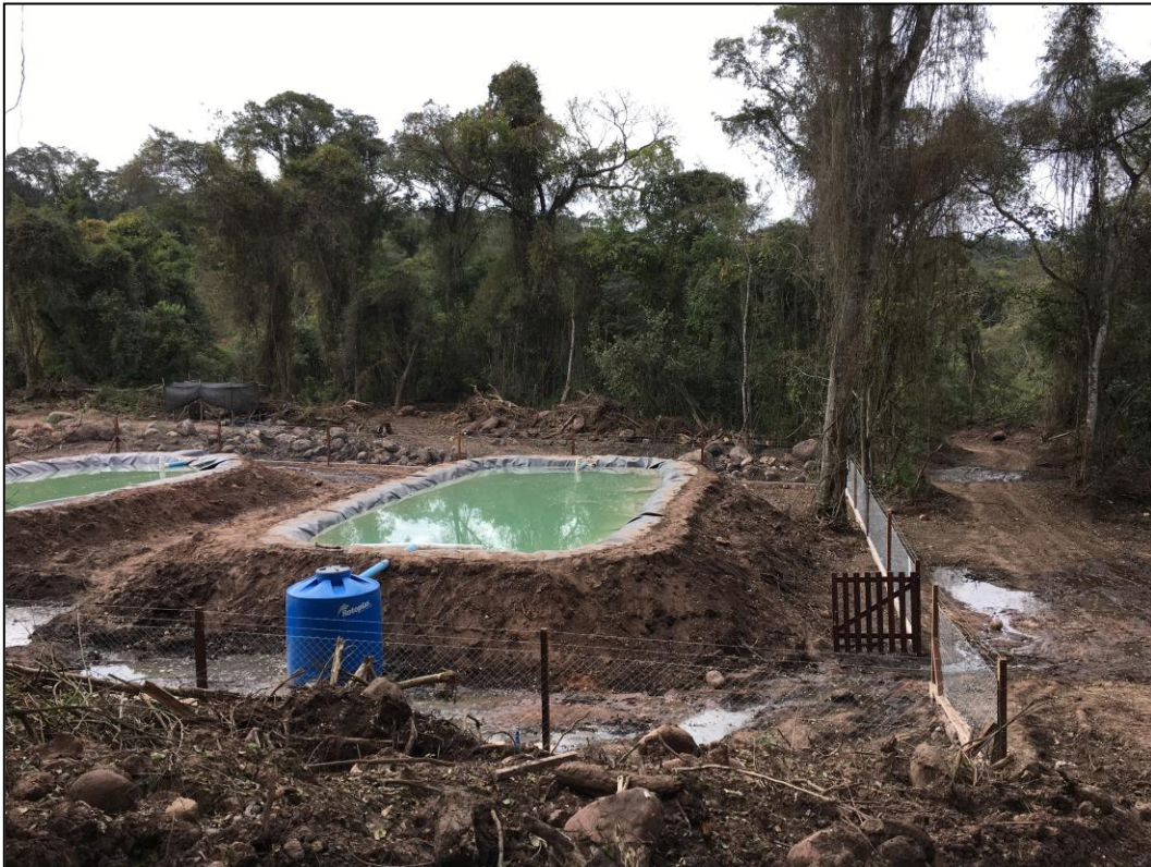
Foto 17: Piletas en funcionamiento
