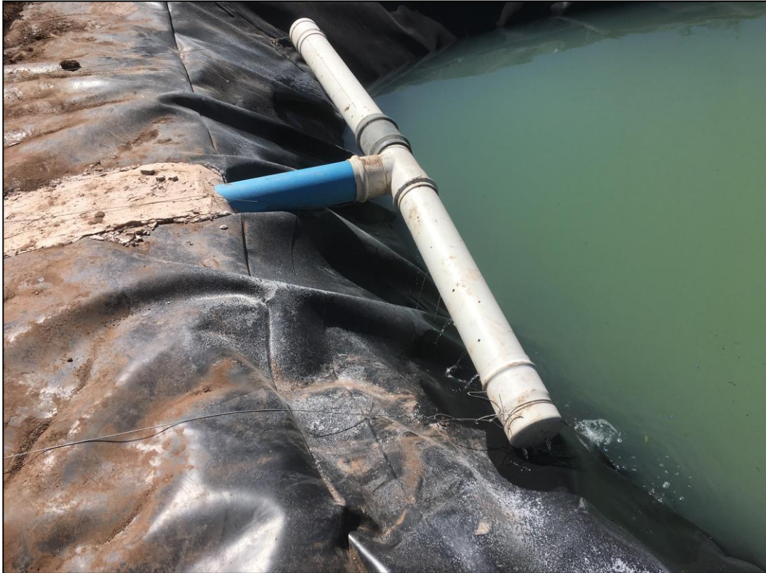
Foto 18: Cañería reductora de velocidad
