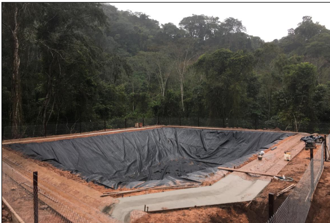
Foto 14: Represa recubierta con membrana de HDPE
