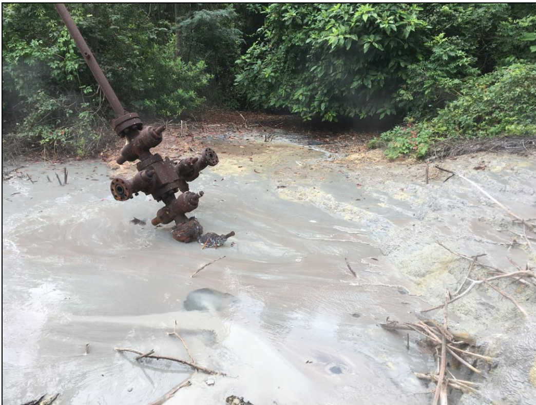
Foto 3: Cabeza de pozo caída y desplazada - Pozo YPF.Jj.CA.E-3
