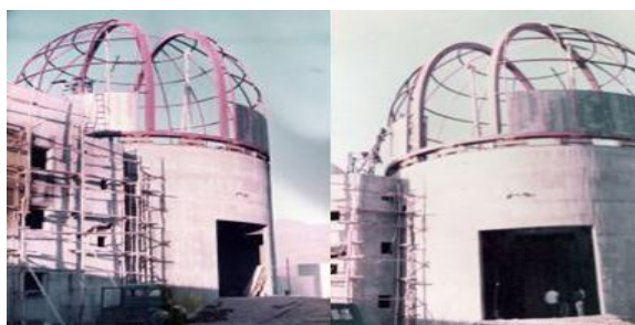
Ilustración 11. Estado de la cúpula, albergue del telescopio de 2,15 m en 1983 (Fotografía del autor) 76
