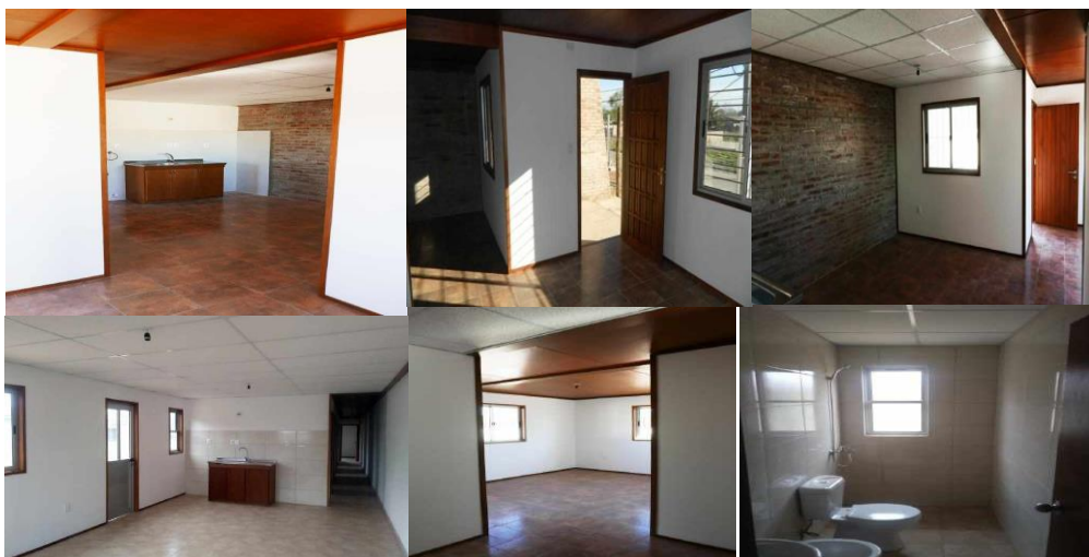
Imagen 19. Terminaciones interiores varias: yeso, zócalos y cornisas, esquineros, cielorrasos, acabados y pinturas
