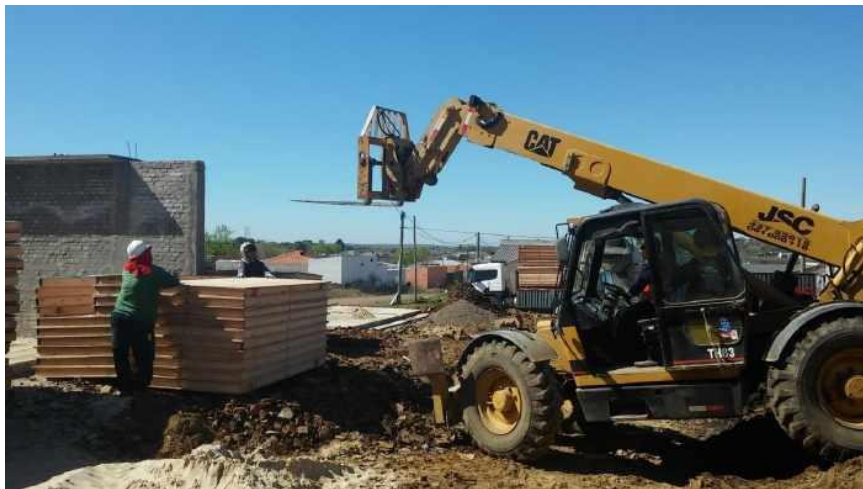
Imagen 13. Descarga con manipulador telescópico en la vivienda correspondiente según identificación en paneles
