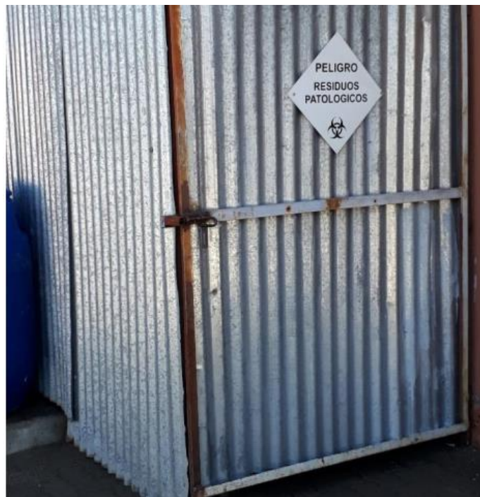
Figura 12. Área de almacenamiento final que no cuenta con la leyenda correspondiente conforme a la normativa. Hospital Sub-Zonal El Maitén.
