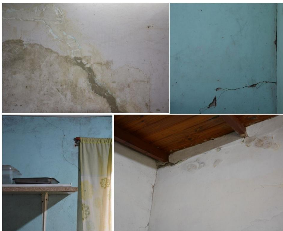
Figura 70. Rajaduras en las viviendas del barrio Santa Inés Capturas propias, 23 de septiembre de 2024
