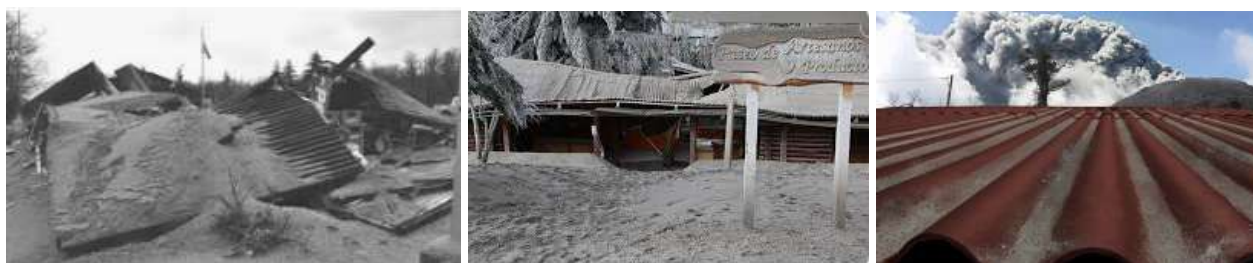
Figura 9: Daños en infraestructuras. Techos caídos. c) Estructuras de zinc alterados, por la presencia de cenizas volcánicas. https://cawtvonline.wordpress.com/2016/01/19/cenizas-volcanicas-generan-danos-a-techos-de-zinc-o-metal/
