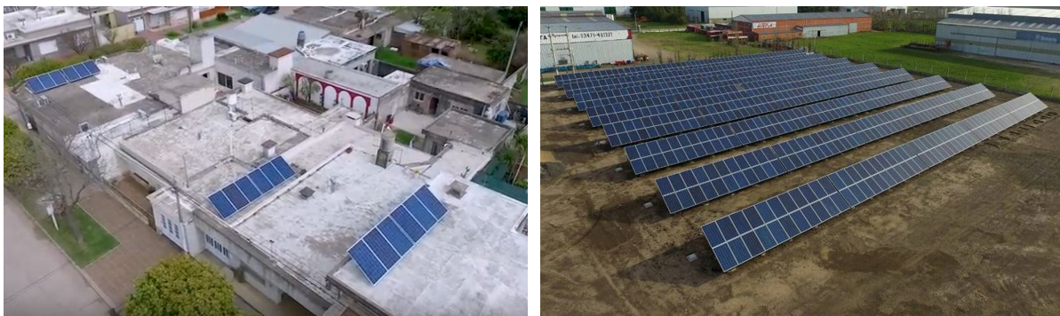
Figura 51: Instalaciones de GDER del proyecto PRIER
