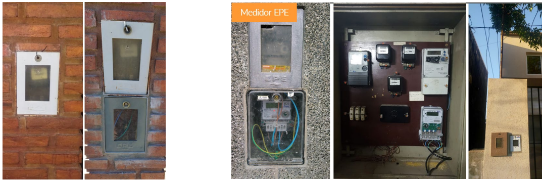
Figura 47: Medidores instalados para sistema NB cumpliendo PRO 103-101
